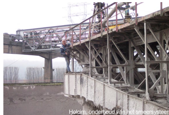
Holcim, onderhoud van het smeersysteem
